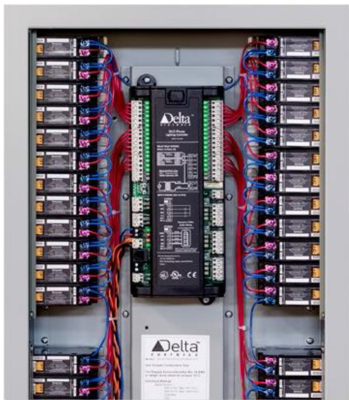
شکل ۵-۲۲: تابلو برق کنترل روشنایی شرکت دلتا کنترلز (Delta Group, 2007)
